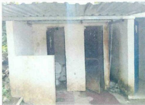
Foto 1: Área de sanitarios. Se requiere cambiar accesorios por deterioro así mismo piso.
